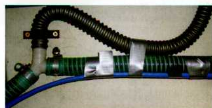
Przewód grzejny na rurze spustowej z wodą ze zlewozmywaka.
